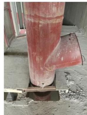
图九: 垃圾管道采用角钢与槽钢固定 4 使用过程中常见问题及解决方案
